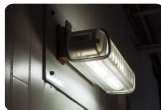
非常用電源の確保/BCP対策
